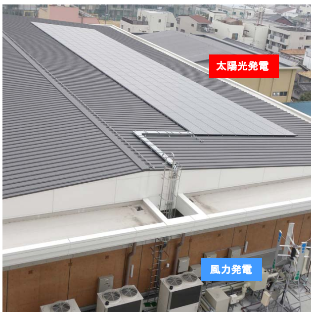
太陽光発電と風力発電が設置された体育館の屋上
