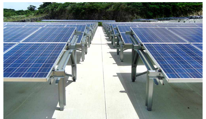
台風に備えて、土台は全面コンクリート基礎に。基礎部分をより平坦にすることで発電効率がアップ
