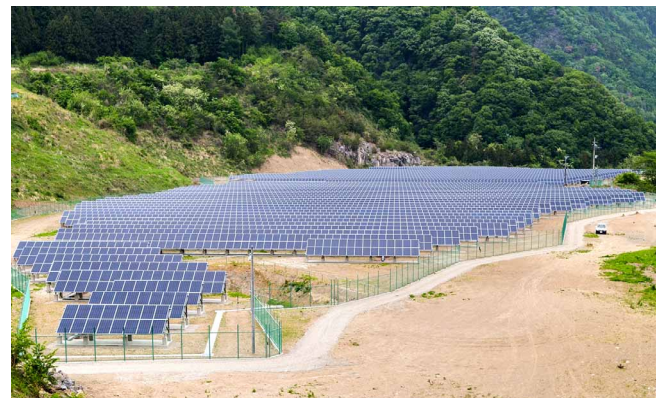
採石場跡地の約4ヘクタールの敷地に発電容量約2.2MW、8,992枚のソーラーパネル
