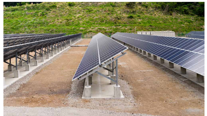
積雪対策のため、設置角度を30度とした上でコンクリート基礎も高さに余裕を持たせて設置
