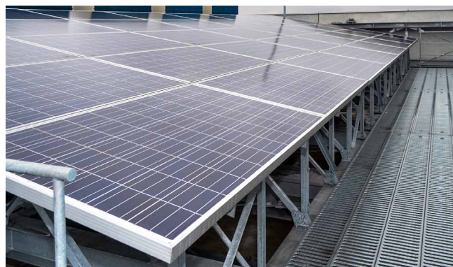
クリーンな太陽光発電でビル内の使用電力の一部をまかないながら、環境負荷も低減
