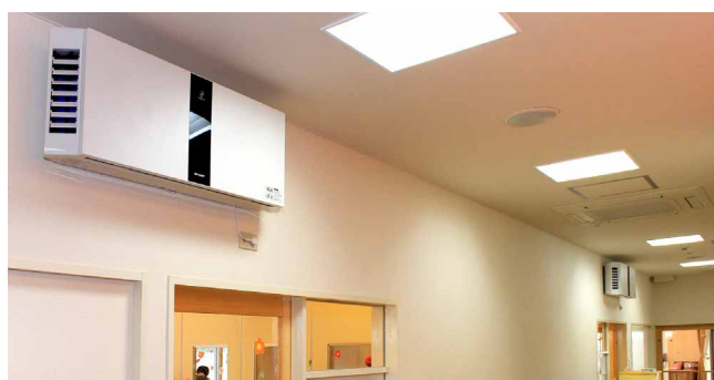
保育室内だけでなく廊下にも設置
