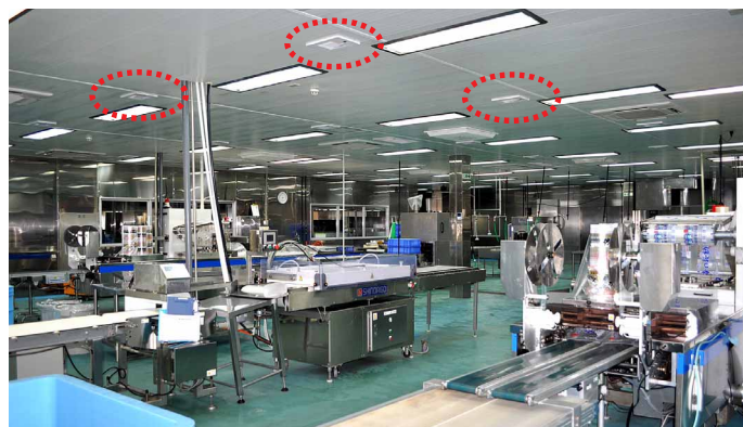
広い工場の天井部分に44台のイオン発生機を設置し、 空間をまるごとプラズマクラスター空間に
