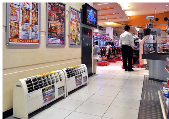
トイレ前の通路には2台設置
