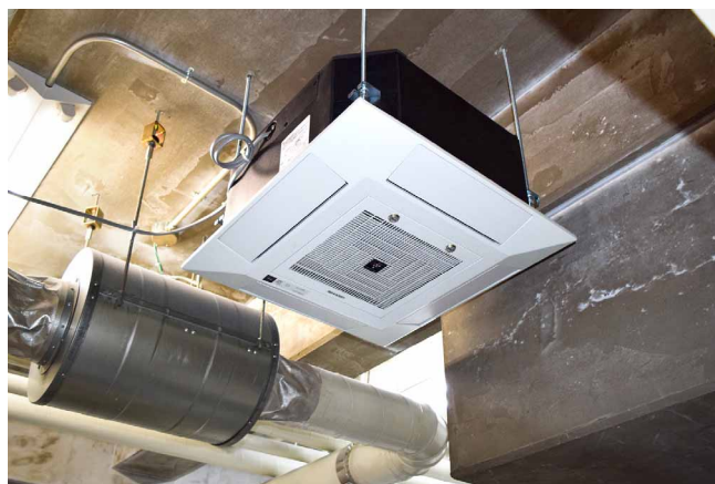
透析液作成機が動作する機械室では静電気除去で効果を発揮
