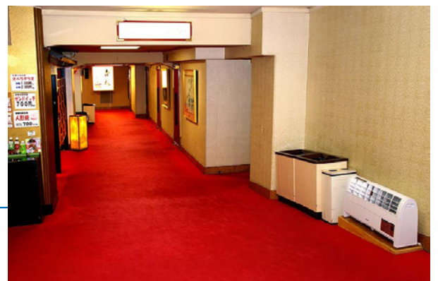
各階のロビーに設置され、お客さまの大きな安心感に。
