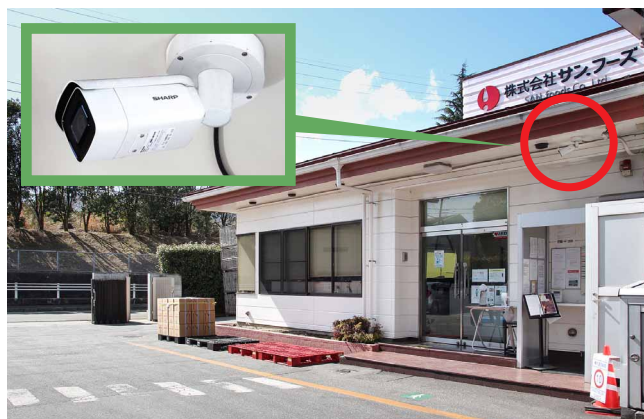
工場正門に向けて抑止力になるバレットタイプを設置
