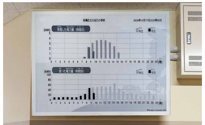
発電量と使用量をグラフでも表示 (板橋区立大谷口小学校さま)
